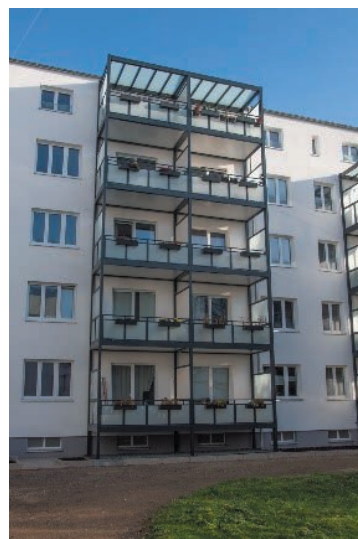
FOT. 2 Balkony dostawiane; fot.: [4]
